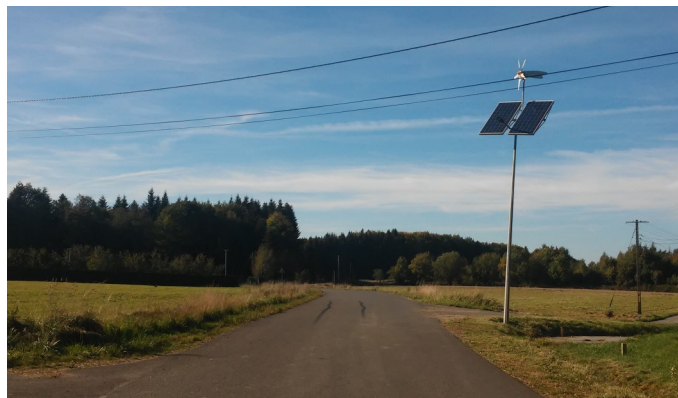
Hybrydowe oświetlenie drogowe w Lisowie
