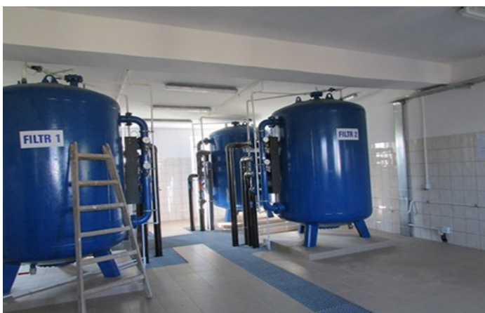
Wypośaenie stacji uzdatniania wody w Przysiekach
